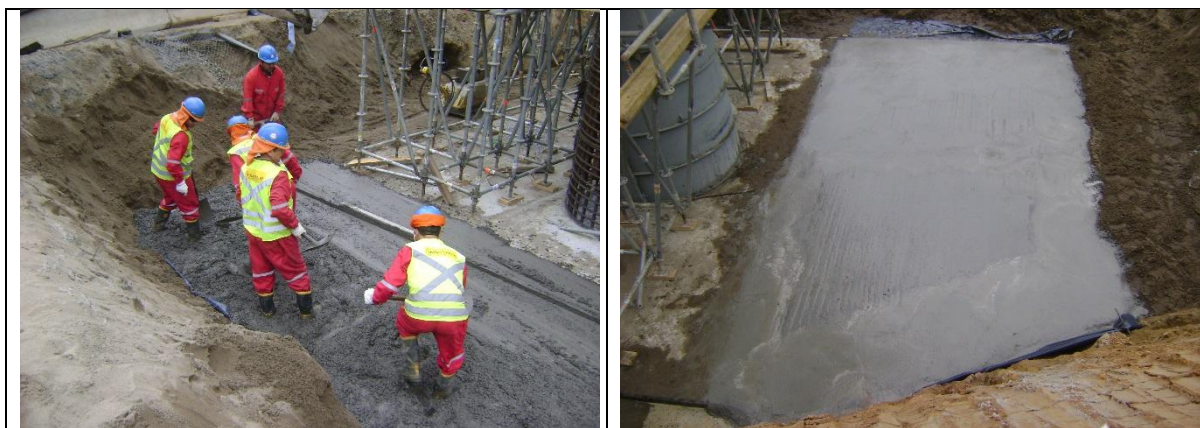
Hormigonado de Emplantillado para Colocación de Cimbra Dintel Cepa N° 3 Tramo A Sector II Viaducto las Cruces km: 44.429,40.
